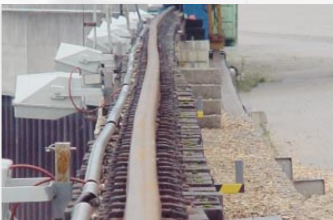
Seitlich starke Abweichung einer Kranbahn
